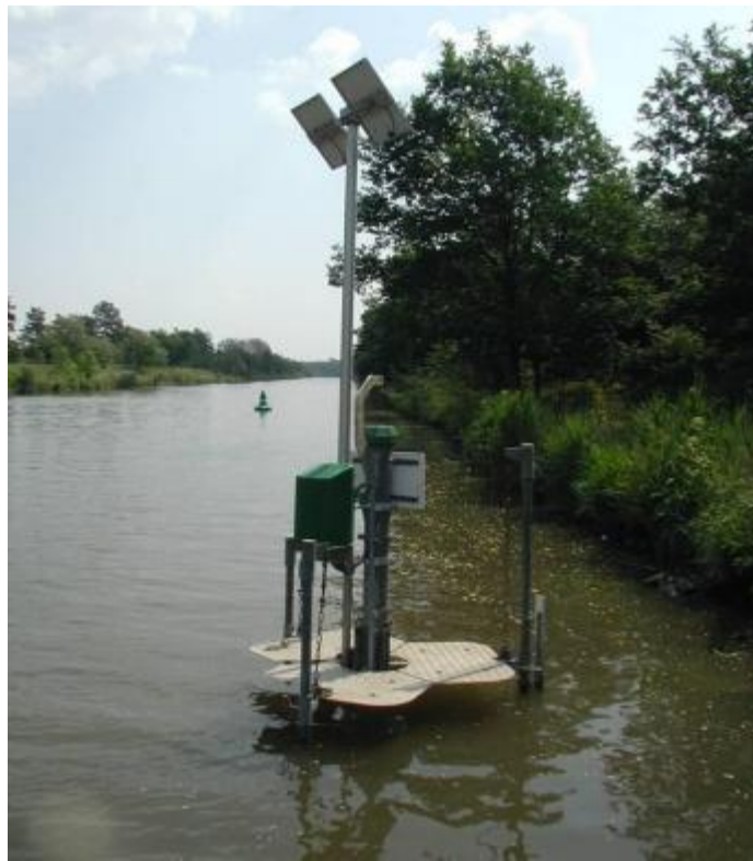
图 3-8 靠近河岸边打桩固定安装的遥测测流系统
