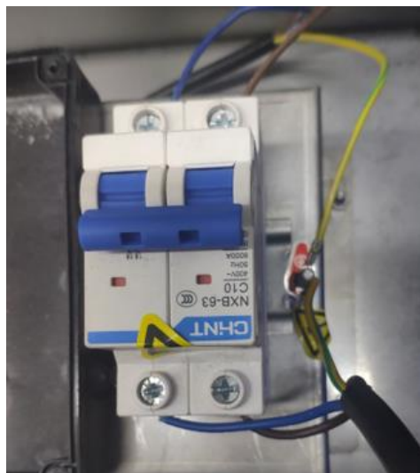
图5-6 系统进线实物图（电源线需自备）
